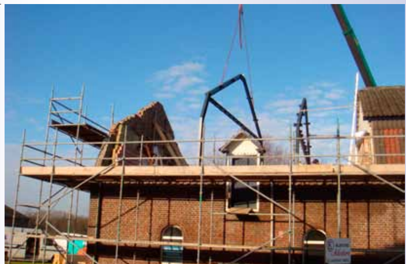
Het plaatsen van de spanten voor het nieuwe dak. Ook zichtbaar een soort dakkapel waardoor vroeger het hooi op de hooizolder gestoken werd.
